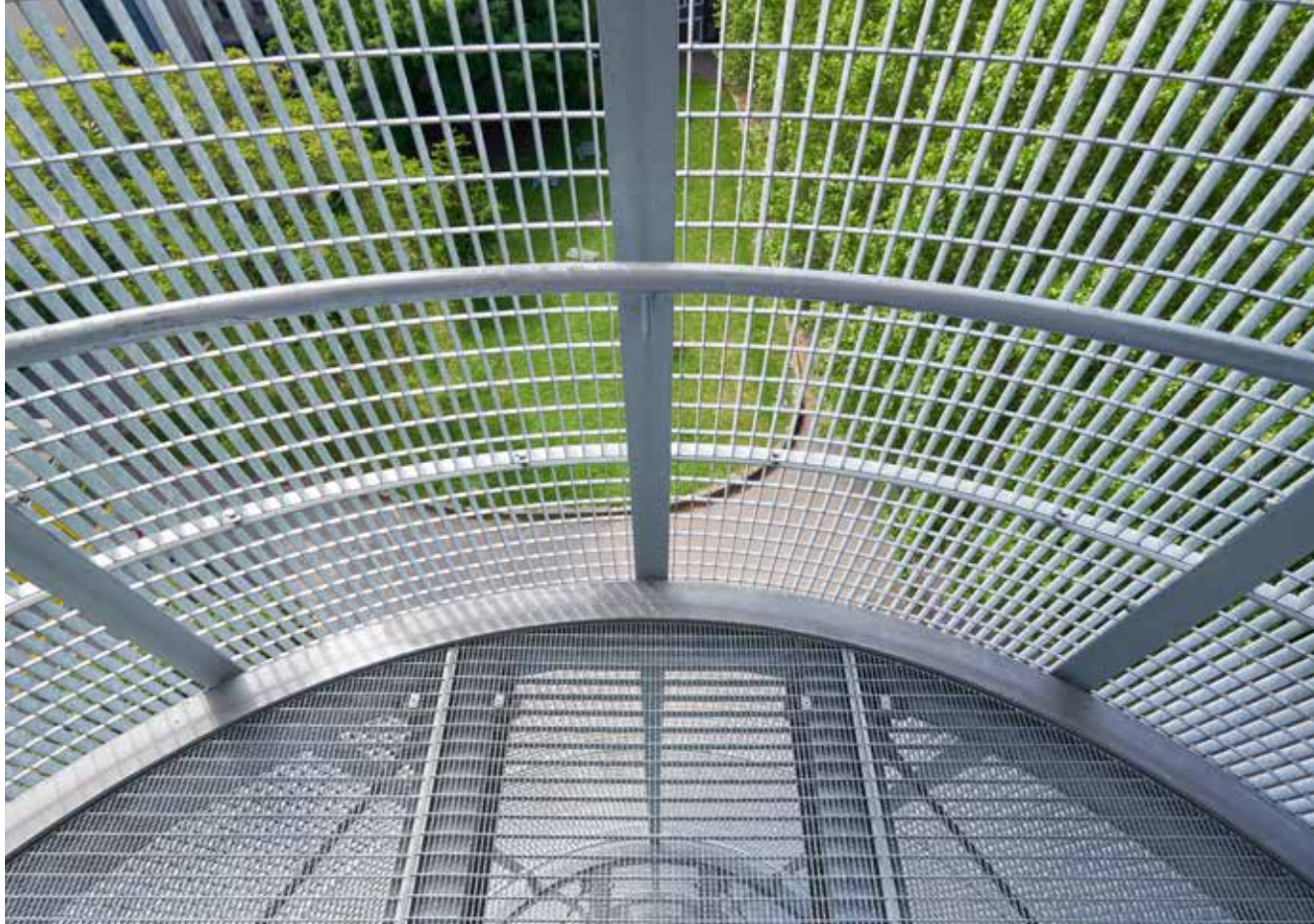
Stabilität bei gleichzeitig freiem Blick - MEISER Stufen, verbaut beim Treppenturm der Hochschule Mannheim
