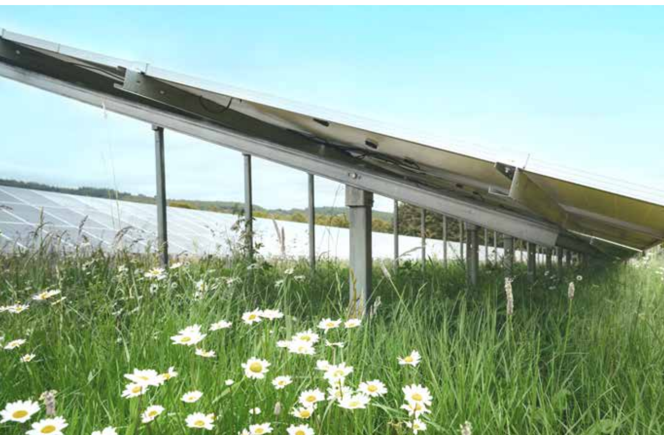
Una estructura de soporte solar de MEISER Solar en Morscholz
