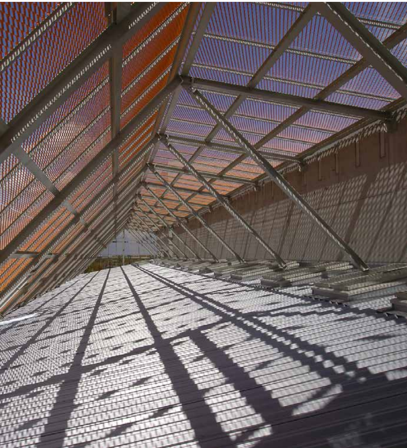
Streckmetall verbaut als Dach der MVA Wien
